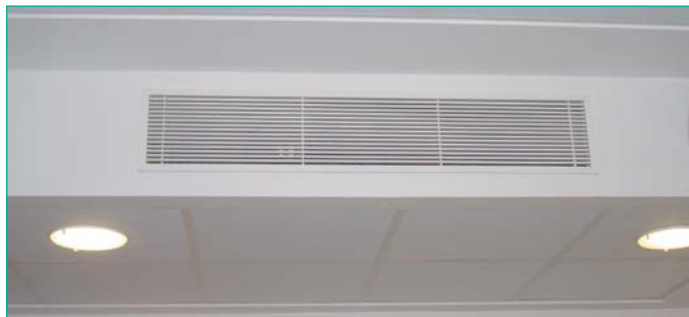
Figura 2 Sistemas de ventilación.
